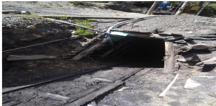
Imagen 3. Guayas: soporte de metal con usos varios dentro de la mina, especialmente el sostenimiento.
